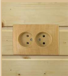
Розетка без заземления
